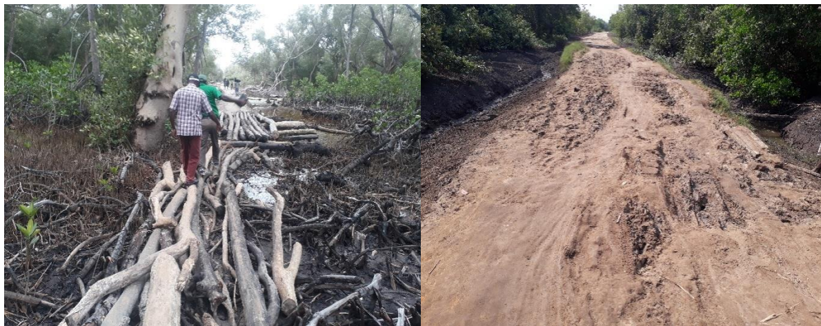
Figura 12: Estado de conservação de algumas rodovias no Banco de Sofala (Out – Nov, 2018)
